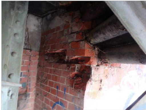
Abb.: Lagersockel gerissen
