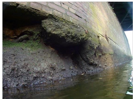
Abb.: Schäden am Widerlager in der Wasserwechselzone
