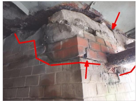
Abb.: Widerlagerwand – Ablösungen Verblendmauerwerk
