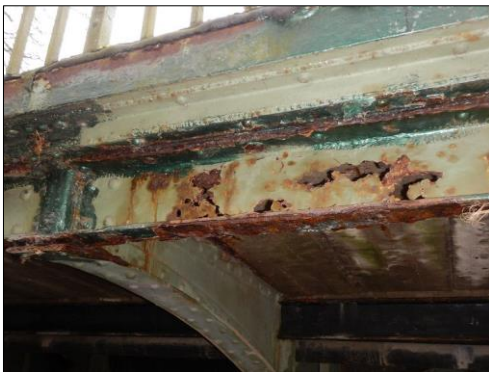
Abb.: Korrosionsschäden an den Gehwegkonsolen (Kragarm) mit Querschnittsschwächung
